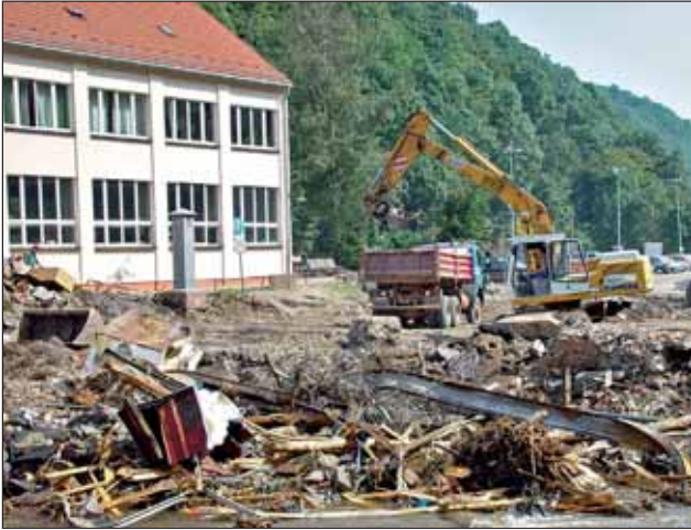
Das Institutsgebäude des Forsttechnik-Lehrstuhls (links) war erst sechs Jahre später wieder voll funktionsfähig. Foto: Henrik Weiß
